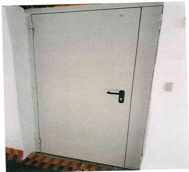
19 Дверь запасного выхода (входная)
